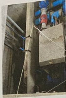
Piscina de cloro
