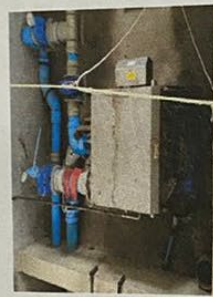
Separador de arena
