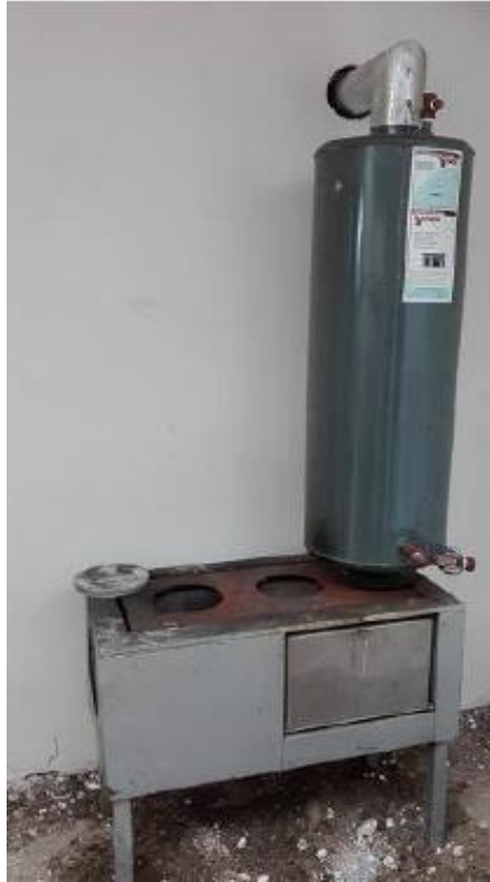
Figura 4: Estanque Adosado a Cañón de Cocina de Biomasa.
