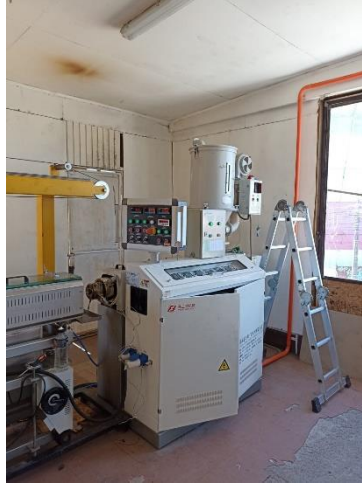
Figura 2.2 Controladores y Tolva Fuente: Elaboración propia
