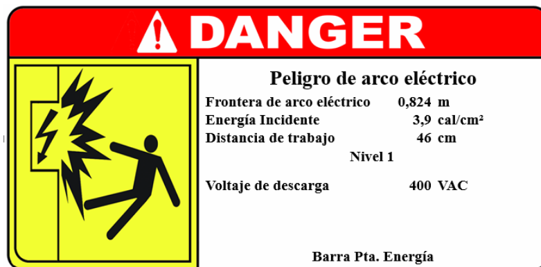
Figura 6.4.1 Etiqueta de peligros barra pta energía y barra ventilador caldera 0,4 [kV].
