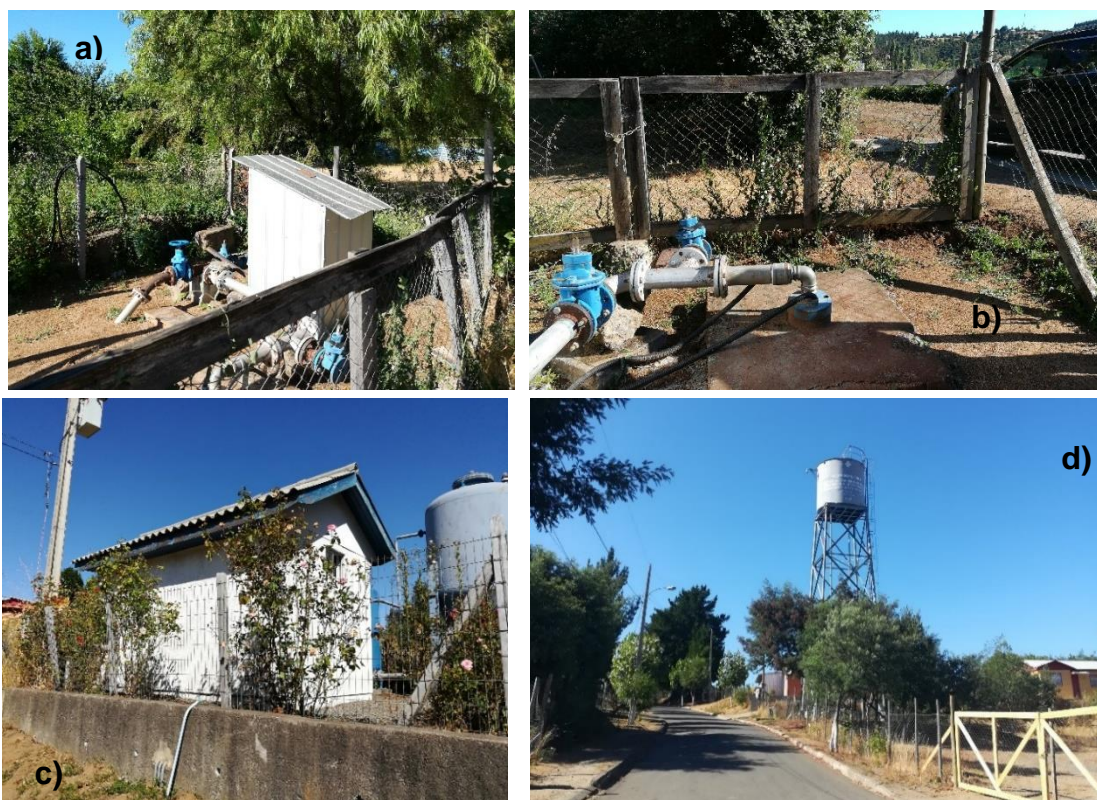
Figura 14. Sistema de agua potable localidad de Tomeco. a) y b) zona de captación, c) caseta de cloración, lugar donde se realiza proceso de desinfección, d) estanque de almacenamiento de agua potable.
