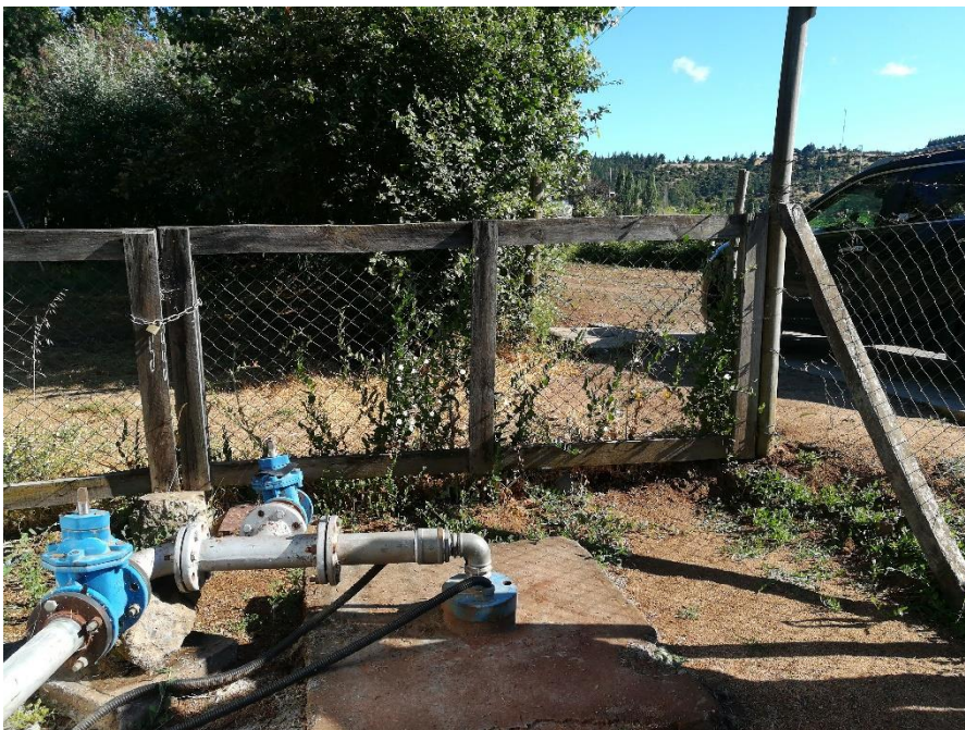
Figura 1. Zona de captación de agua potable.
