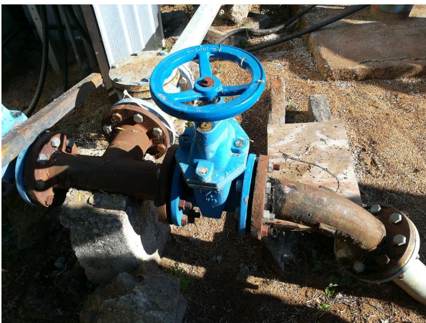
Figura 2. Presencia de óxido en tuberías.
