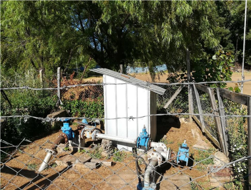
Figura 3. Caseta de protección sistema eléctrico.
