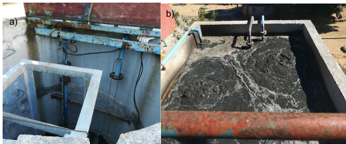
Figura 1. a) se muestra la planta elevadora, b) sistema de tratamiento de lodos activados.
