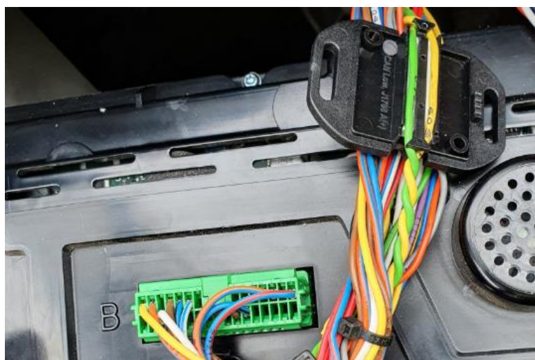
Figura 3.1. Instalación de sensor CL-CAN en RedCAN verde-amarillo [3].
