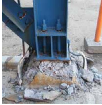
Figura 1.3. Falla típica de pedestal. (Montecinos, 2012)
