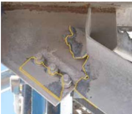
Figura 1.1. Falla arriostramiento por bloque de corte. (Montecinos, 2012)
