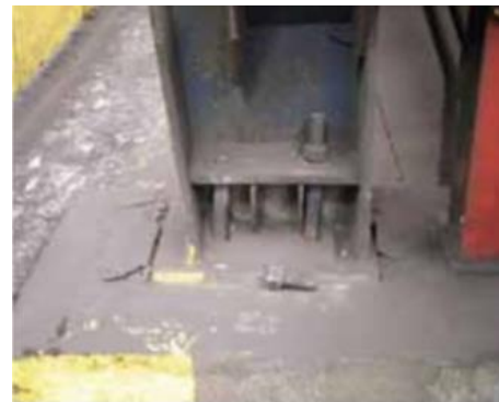
Figura 1.2. Rotura pernos de anclajes. (Montecinos, 2012)
