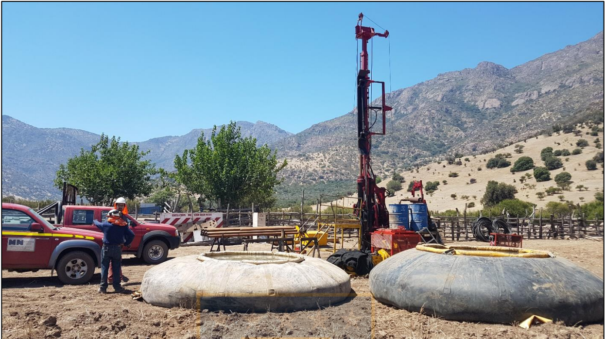
Figura 1.2. Equipo de perforación. Equipo de perforación marca Boart Longyear 38.
