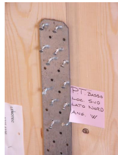
b) Daño en conector a tracción
