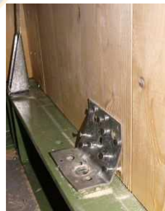
b) Daño en conector de corte
