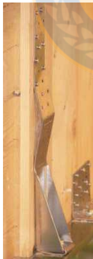
a) Daño en conector a tracción
