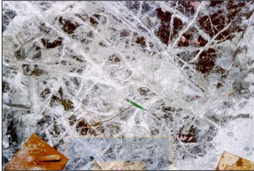
Fotografía 3.1: Enrejado de vetillas ( Stockwork ). Compuesto por vetillas TM con relleno de cuarzo. La separación de los pernos es de 1 m. Imagen tomada de Karzulovic (2001).
