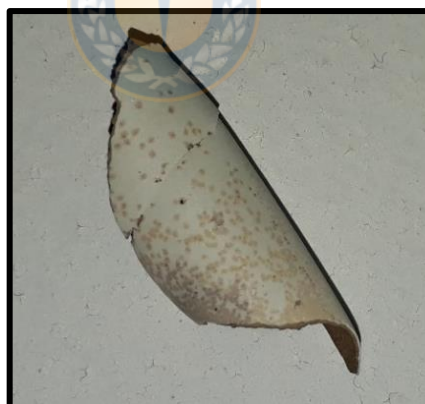
Figura 43. Sección de pintura anticorrosiva y recubrimiento desprendido del sustrato. Fuente propia
