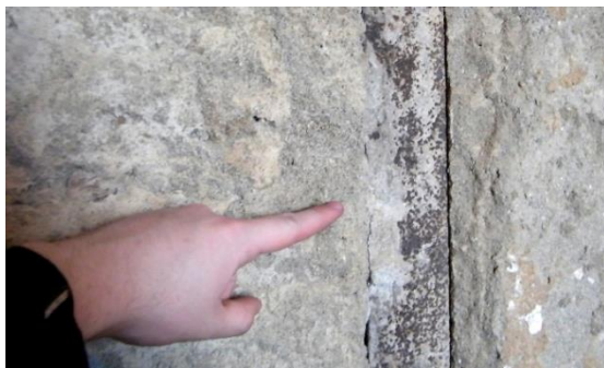
Fig. 5. Detalle de junta perfil-relleno, acusando fisura.
