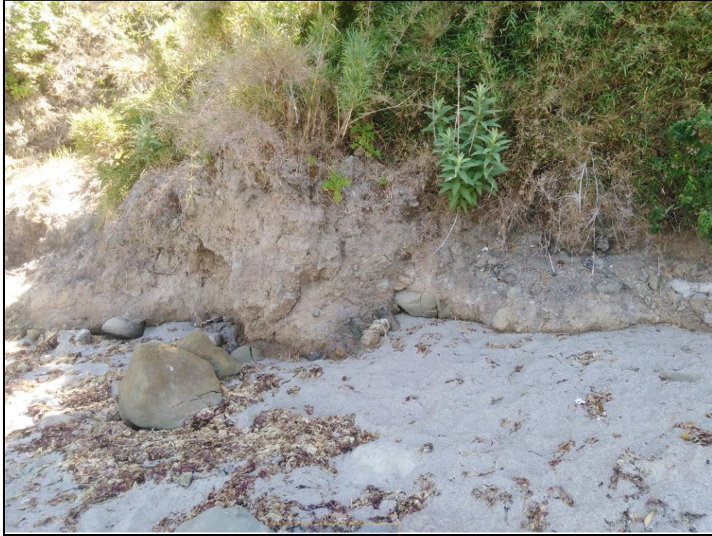
Fotografía 11: Depósitos de remoción en masa en punto 4H.
