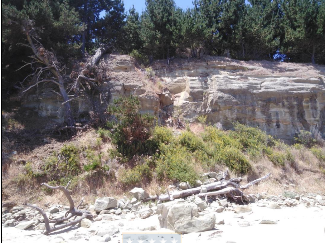
Fotografía 21: Depósitos de remoción en masa en punto 4R.
