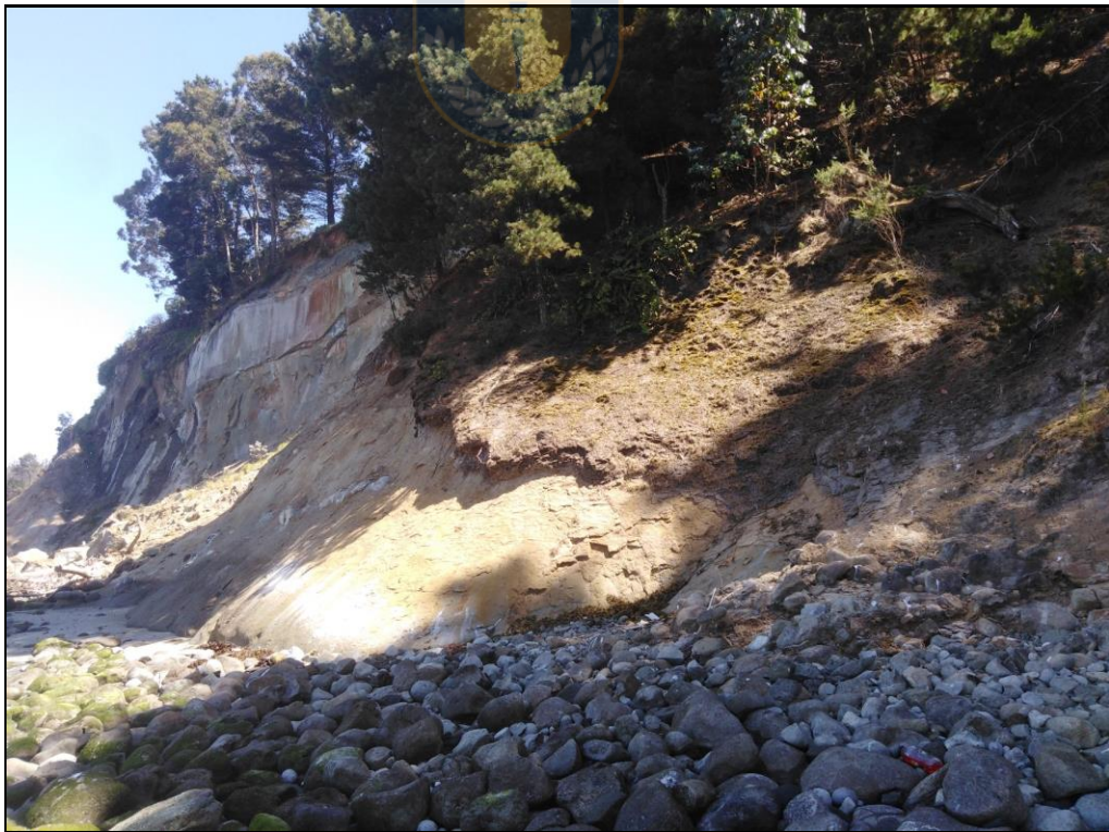
Fotografía 10: Depósitos de remoción en masa en punto 4G.
