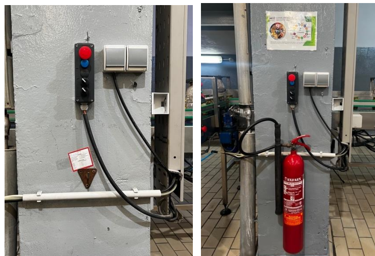
Figura 5.5: Reposición extintores faltantes.
