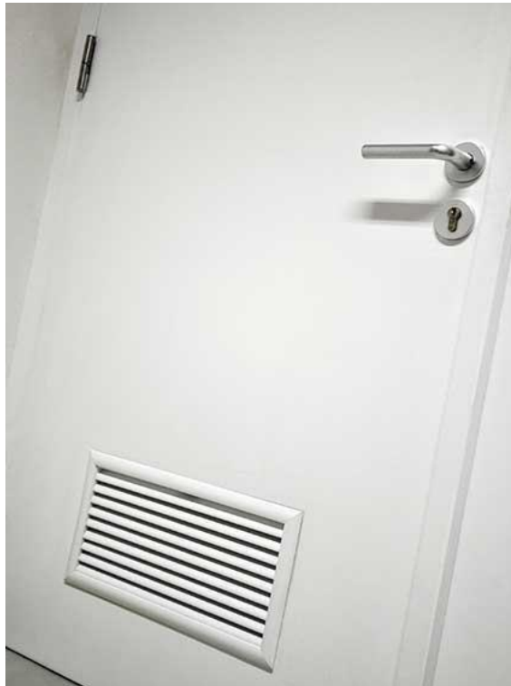
Figura 2.24 Rejilla en puerta, ejemplo de abertura de paso. Fuente [22]
