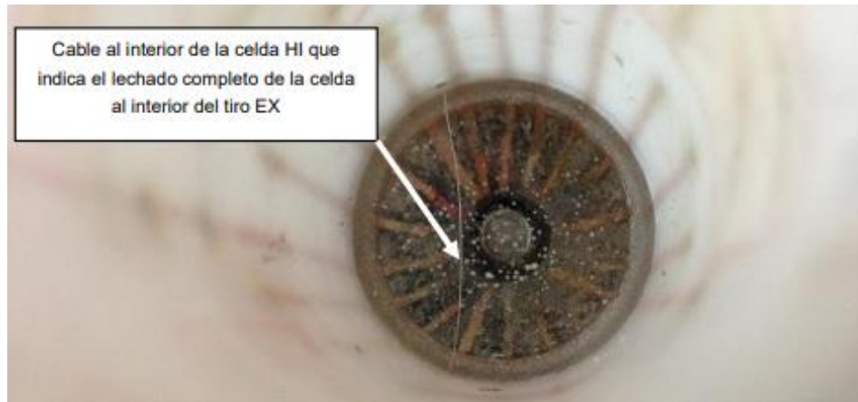
Figura 3.15: Cable al interior de la celda que indica el lechado completo [14].
