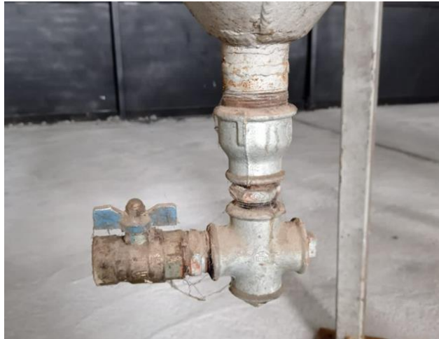
Figura 3.9: Estado de válvulas y accesorios.
