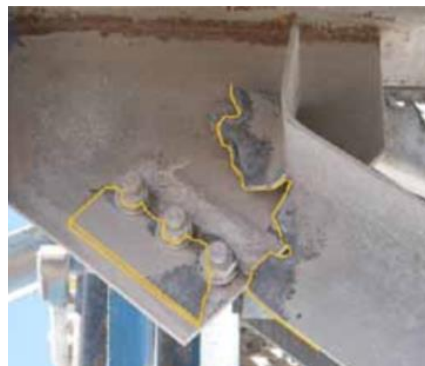
Figura 1.4. Falla arriostamiento por bloque de corte. (Montecinos, 2012)
