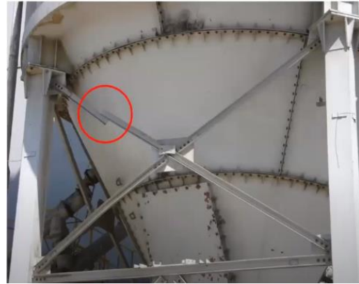
Figura 1.6. Fractura arriostramiento. (Peña & Montecinos, 2020)
