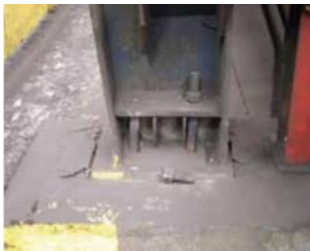
Figura 1.3. Rotura pernos de anclajes. (Montecinos, 2012)
