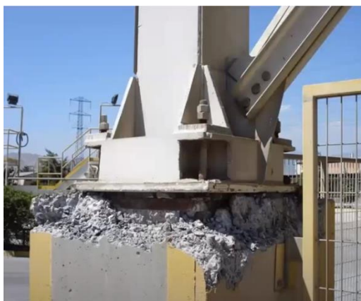
Figura 1.1. Falla típica de pedestales. (Peña & Montecinos, 2020)
