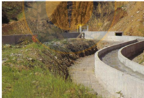
Figura 3.5 Canaleta de relaves (el teniente)
