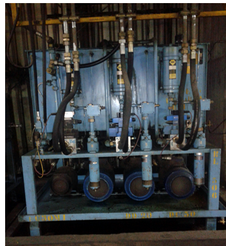
(b) Central Hidráulica Interlog 009.
