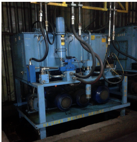
(a) Central Hidráulica Interlog 008.
