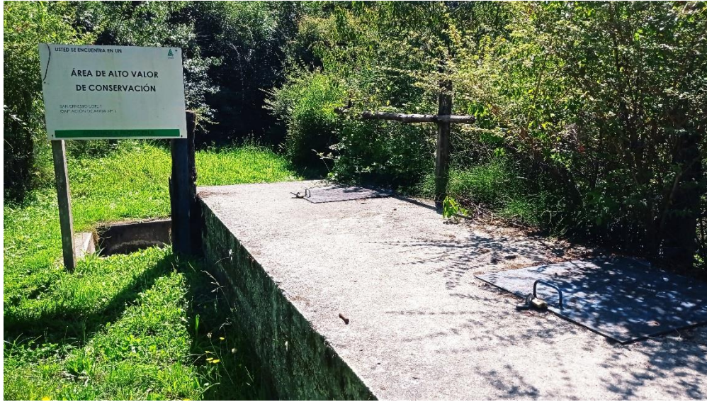
Figura N°12: Instalaciones en bocatoma de agua de APR Calebu-Elicura.
