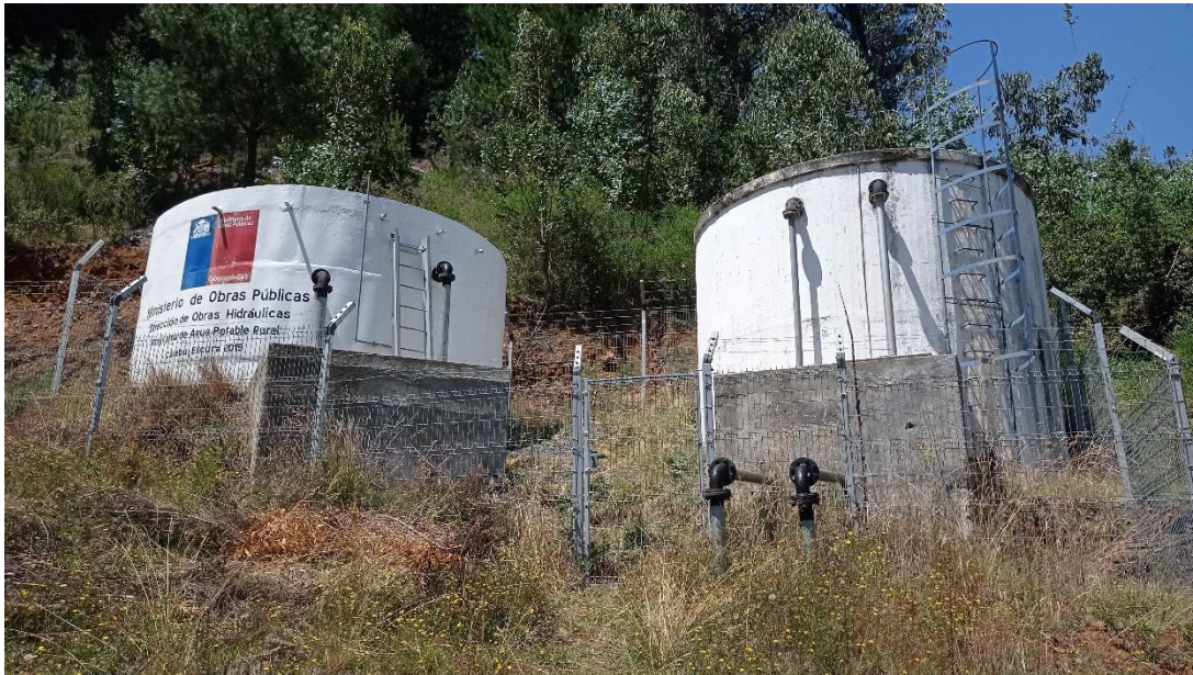
Figura N°29: Estanque de almacenamiento de agua APR Calebu-Elicura.
