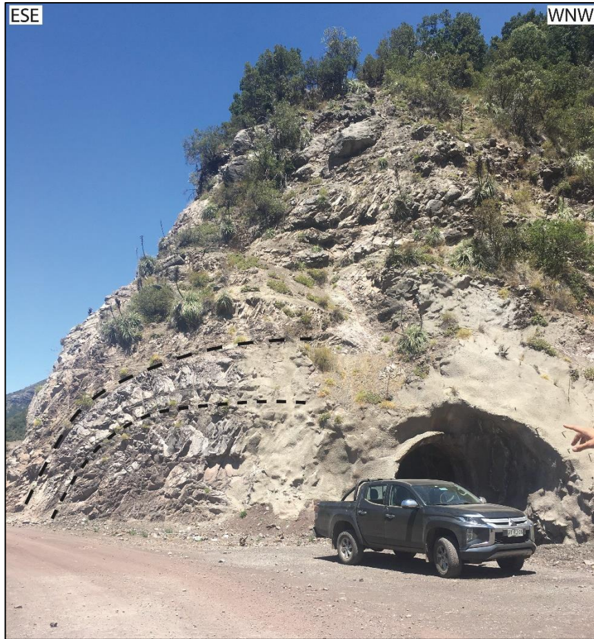
Figura 3.35: Extensión de anticlinal de Qda. Perillar. Observado a orillas del canal Melado, se observa un cabeceo al NE del pliegue.
