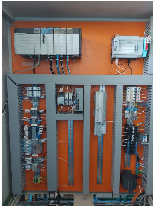
Figura 6.1.4. PLC Allen Bradley 1756 de la planta piloto
