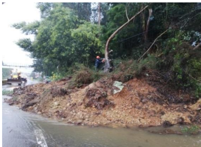
Figura 1. Deslizamiento de Tierra en Penco
