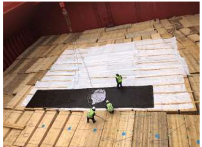
Figura 2.2: Ubicación de planchas de hierro en bodega de la nave.
