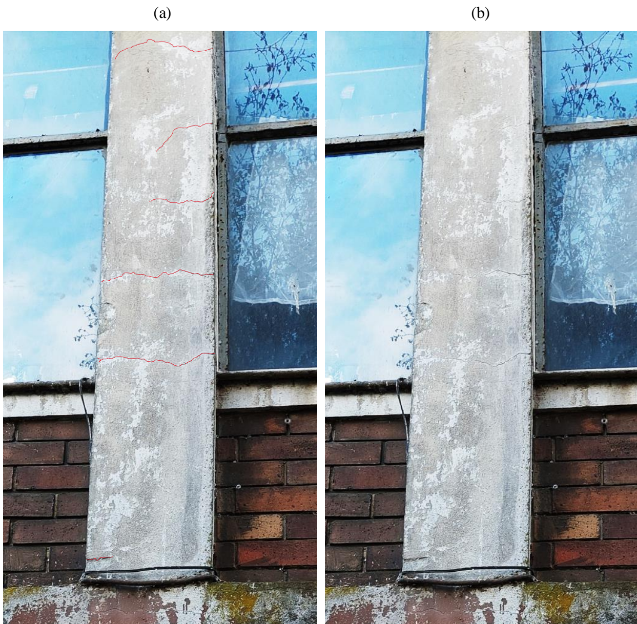
Figura A.4.5.1. 15 Pilar edif. DIDECO eje K- 6. (a) grietas en color rojo y (b) grietas a la vista.
