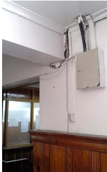
Figura A.4.5.1. 5 Grietas elevación DIDECO eje E, Fig. A.4.5.1.6(b).
