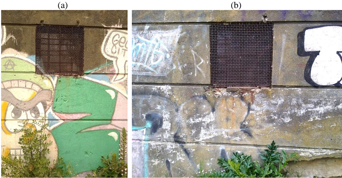
Figura A.4.5.1. 11 Grietas elevación DIDECO eje 10: (a) y (b) de Fig. A.4.5.1.10(a).
