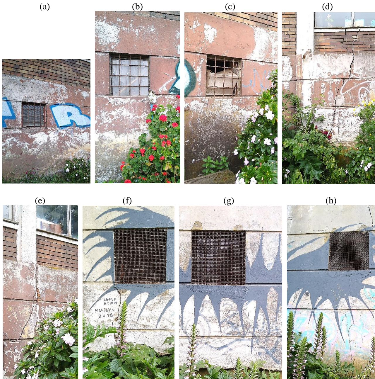
Figura A.4.5.1. 1 Grietas ejes J-K-I. (a), (b), (c), (d), (e), (f), (g) y (h) de Figura A.4.5.1.2.
