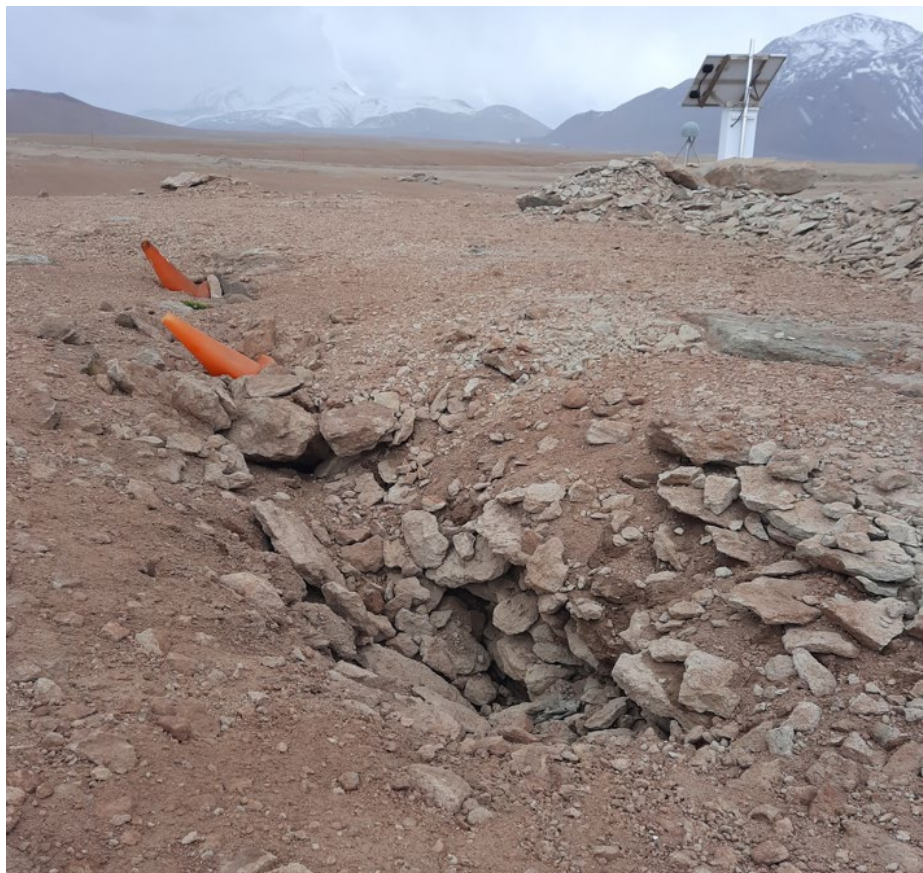
Figura A.2.1.4 Socavón en terreno con toba volcánica, guijarros sueltos y arena
