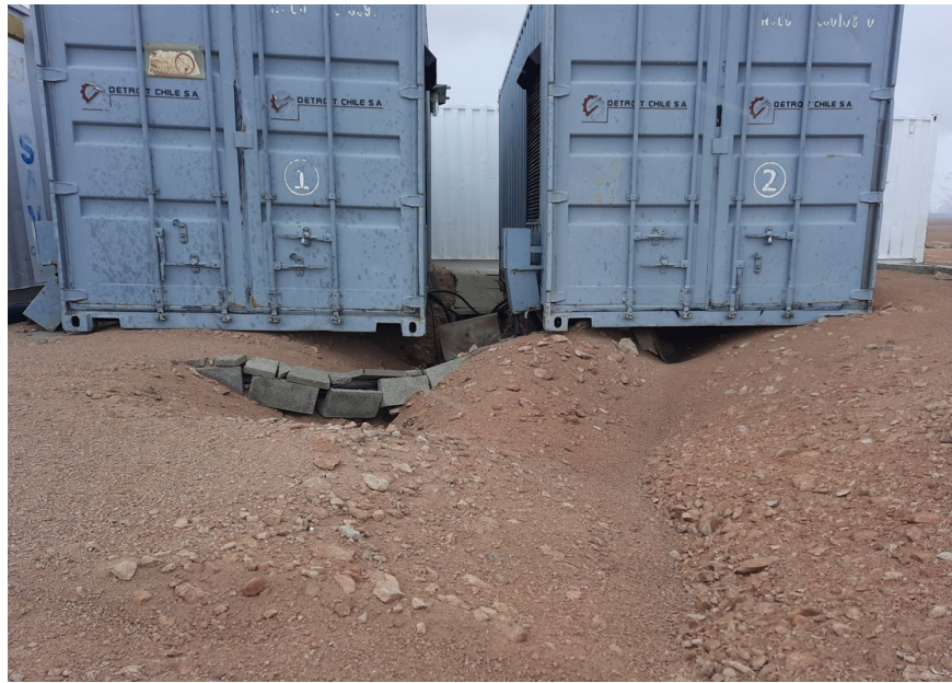
Figura A.2.1.5 Socavón en terreno con toba volcánica, guijarros sueltos y arena
