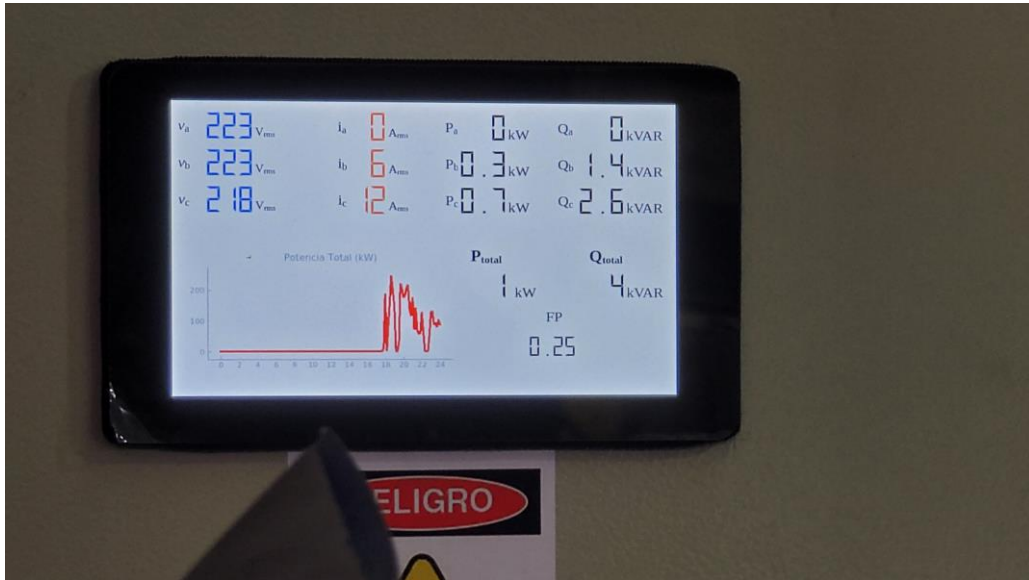
Figura 5.9: Interfaz local de monitoreo en operación.
