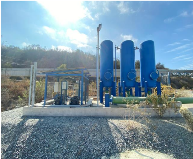
Figura 3.14: Estanques verticales con compresor instalados en la minera.
