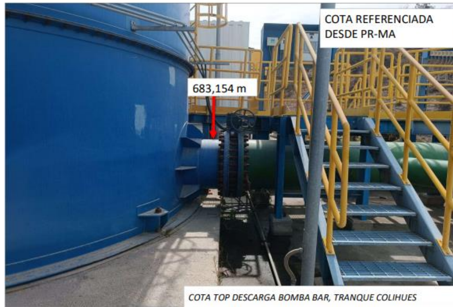
Figura 3.12. Cota de alimentación de la estación de impulsión. Fuente: [Foto capturada por el autor].
