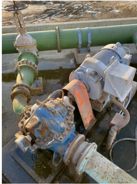
Figura 3.8: Conjunto Bomba BAR – Motor. [Fuente: Foto capturada por el autor].
