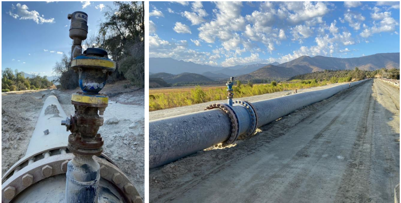
Figura 3.4: Válvula ventosa instalada en la minera. Fuente: [Foto capturada por el autor].
