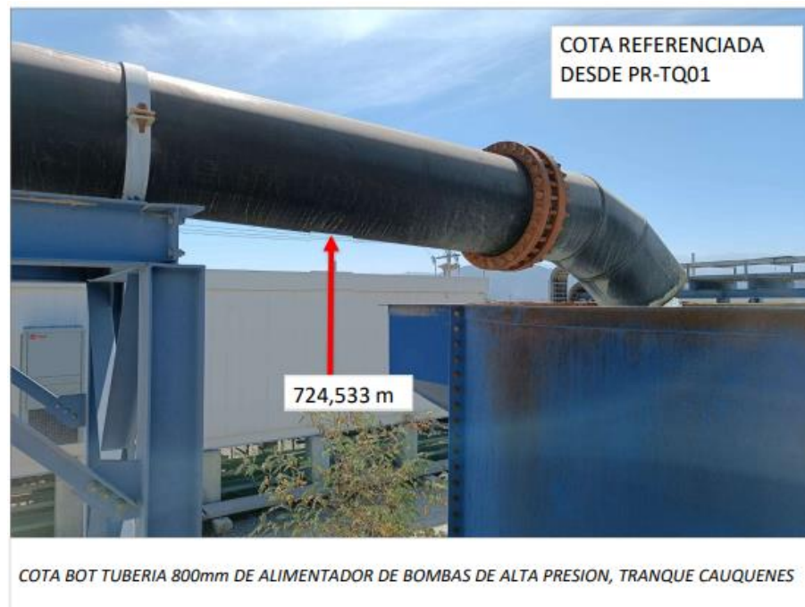
Figura 3.13. Cota de descarga de la estación de impulsión. Fuente: [Foto capturada por el autor].
