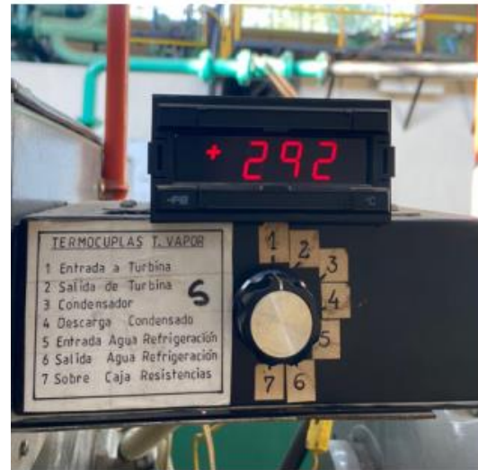
Figura 2.12: Panel Eléctrico de Temperaturas [11]
