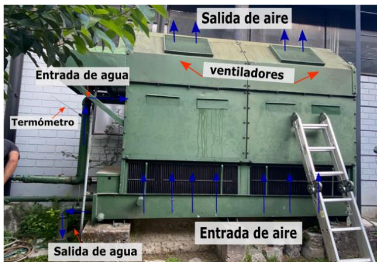
Figura 2.16: Torre de Enfriamiento [11]
