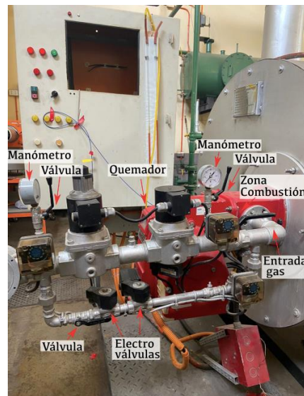
Figura 2.5: Quemador a Gas Natural de la Caldera
