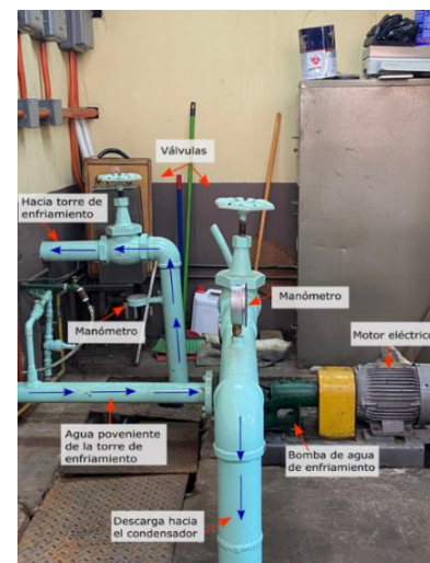
Figura 2.17: Zona de Agua de Enfriamiento [11]
