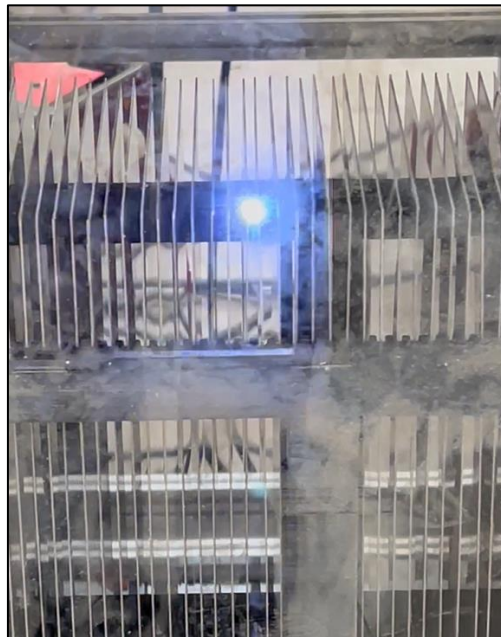
Figura 67: Arco eléctrico en placas del precipitador.
