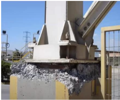
Figura 1.1. Falla típica de pedestales. (Peña & Montecinos, 2020)
