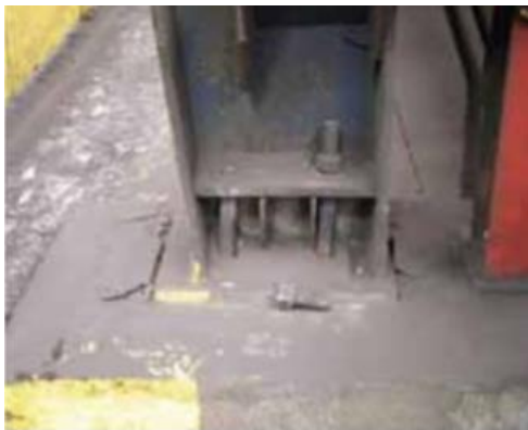
Figura 1.3. Rotura pernos de anclajes. (Montecinos, 2012)
