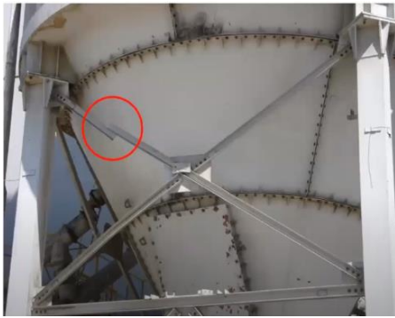
Figura 1.5. Fractura arriostramiento. (Peña & Montecinos, 2020)
