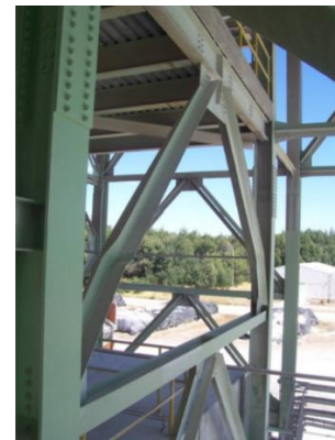
Figura 1.4. Pandeo global de diagonales producto de pandeo local (Montecinos, 2012)
