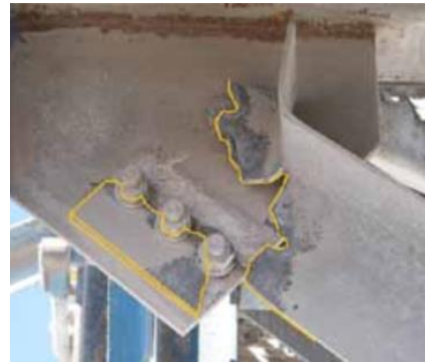
Figura 1.6. Falla arriostramiento por bloque de corte. (Montecinos, 2012)
