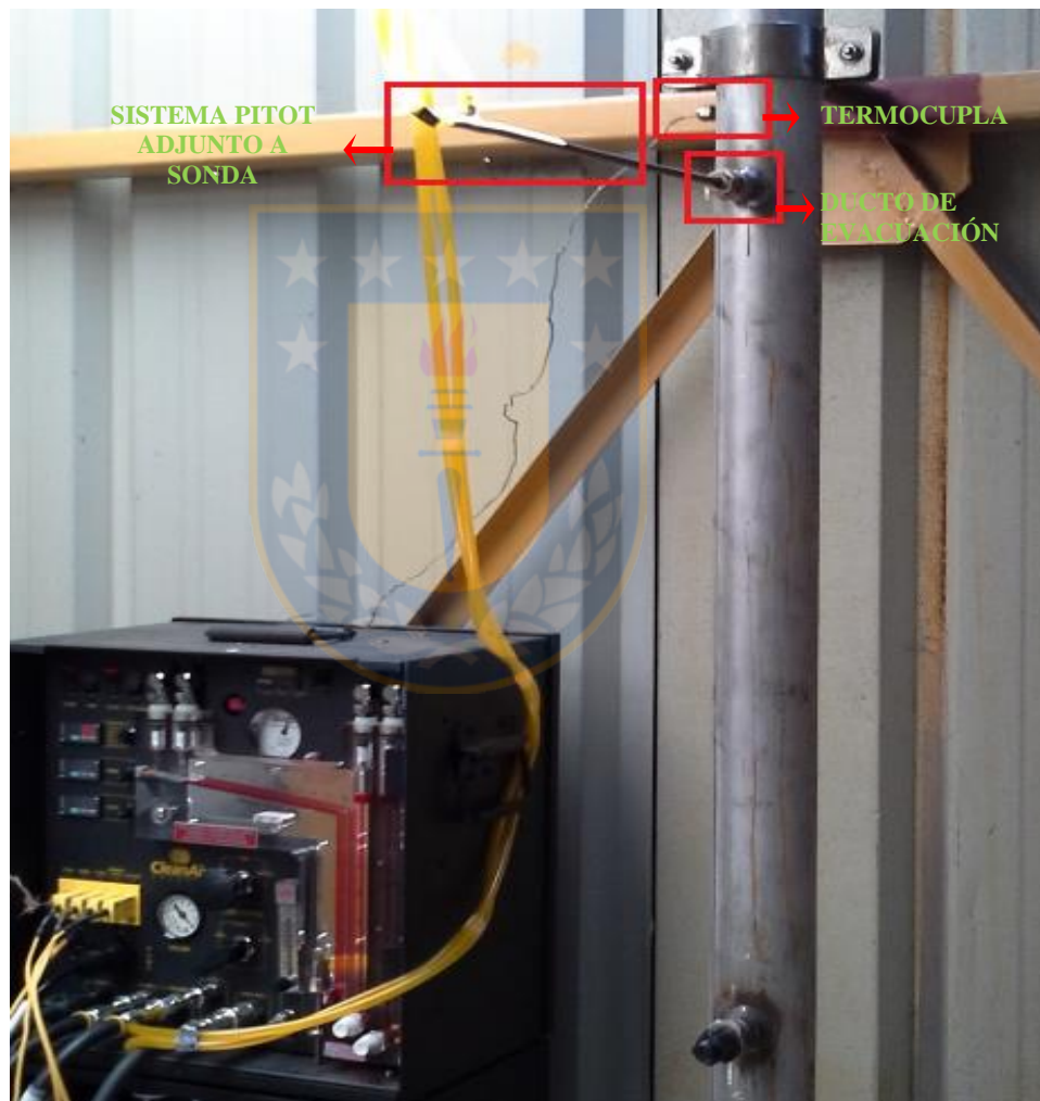
Figura 9. Puerto de medición de velocidad de los gases en el ducto de evacuación de gases de la planta piloto
