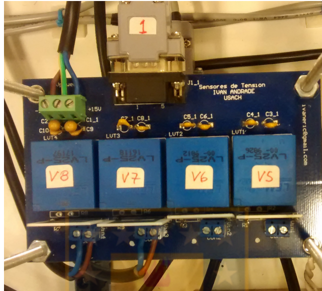
Figura 4.9: Tarjeta de medición de tensiones formada por los LV25P [Fuente: elaboración propia].
