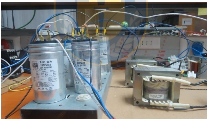
Fig. 4.23 Componentes del banco de filtros pasivos
