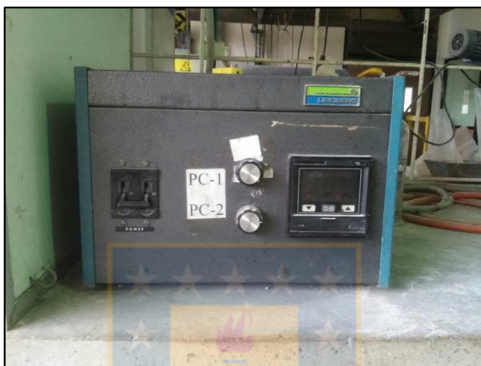
Figura 10. Controlador de temperatura Lindberg.
