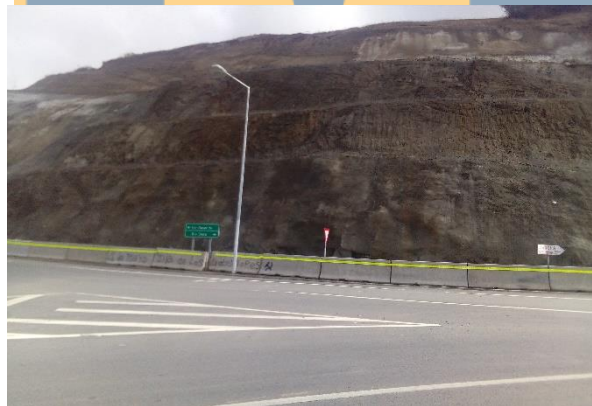
Figura 2: Talud entrada a San Rosendo, Región del Biobío
