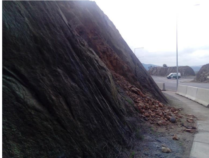
Figura 4: Talud entrada a San Rosendo, Región del Biobío
