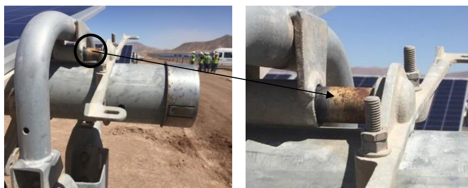
Figura 18. Componente estructural corroído- Planta solar El Bolero Este.
