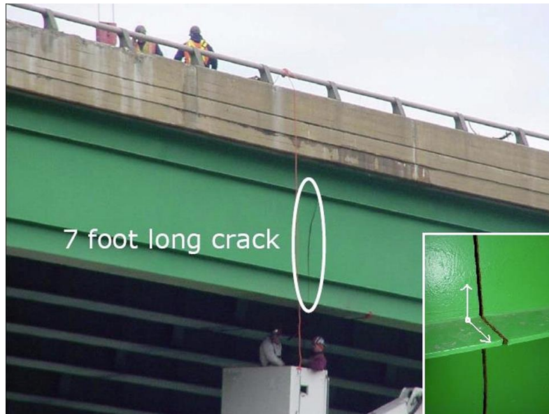
Figura 2.3 Grietas por fatiga en una viga de puente que comienzan en defectos de soldadura en un punto de intersección de soldaduras.
