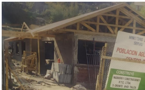
Figura 37: Construcción de la sede social en la población Agüita de la Perdiz
