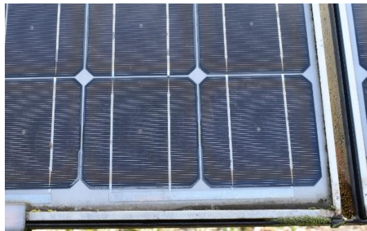
Figura 23. Musgo en la orilla de los paneles solares.
