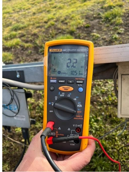
Figura 14. Prueba de aislamiento con tensión de prueba de 1.000 V.
