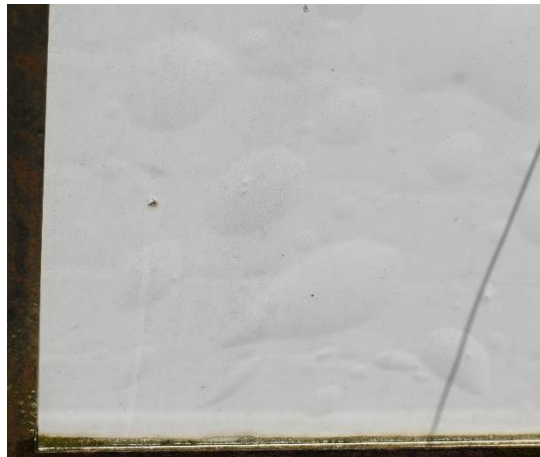
Figura 17. Delaminación en la parte trasera del panel 3.
