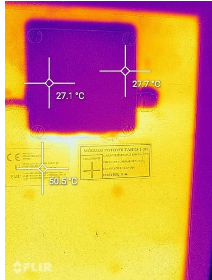
Figura 24. Imagen termográfica parte trasera del panel 1.
