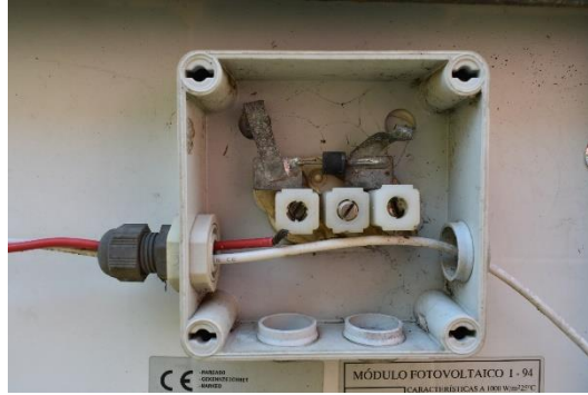
Figura 22. Deterioro de la caja y tornillos Hundidos.
