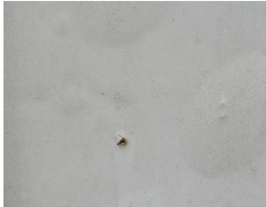
Figura 18. Parte trasera del panel 3 con rotura en la cubierta e inflamación.
