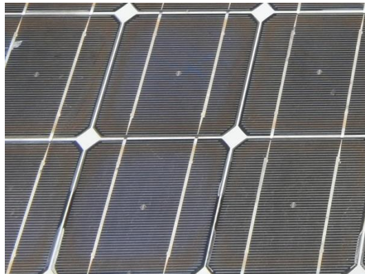
Figura 21. Cambio de color y delaminación en las interconexiones.
