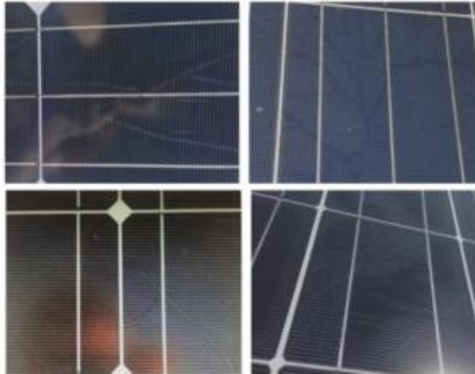
Figura 8. Imágenes de un panel con grietas y microgrietas
