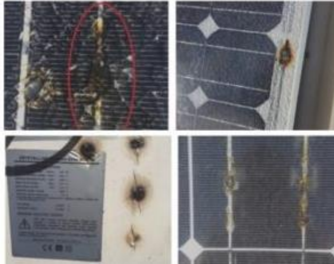
Figura 9. Módulos fotovoltaicos dañados por puntos calientes
