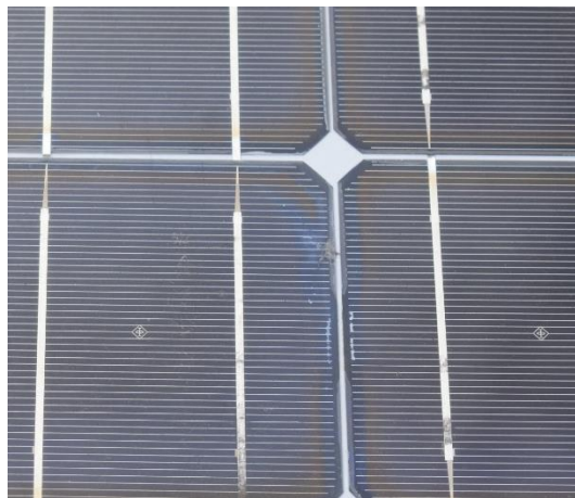
Figura 19. Falla en la celda del panel 3.
