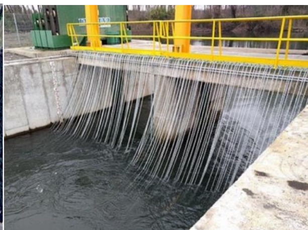
Figura 6.19. Barrera de cadenas en bocatoma. Fuente: Informe de efectividad de la medida FN-9, septiembre de 2016.
