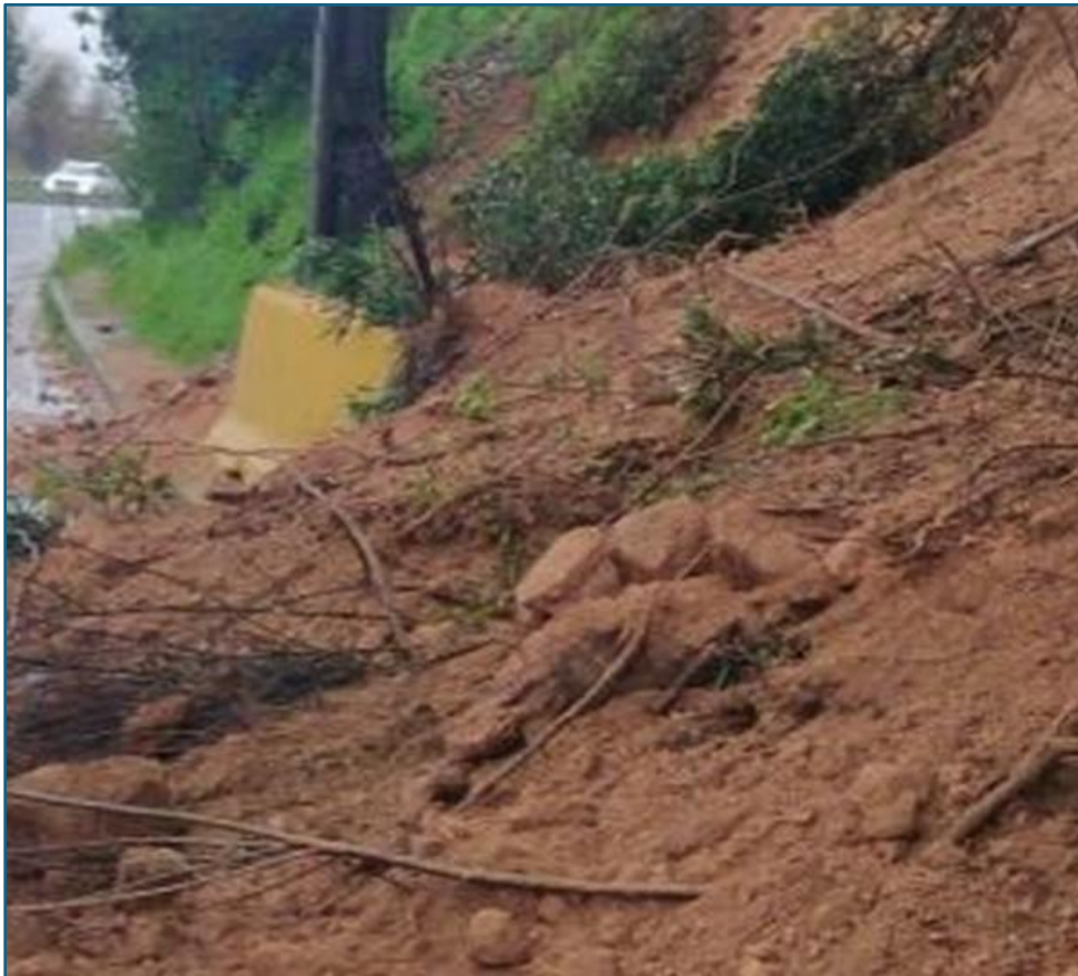
Figura 3: remoción en masa reciente en la Región del Biobío, evidenciando deslizamientos de ladera e interrupción de caminos
