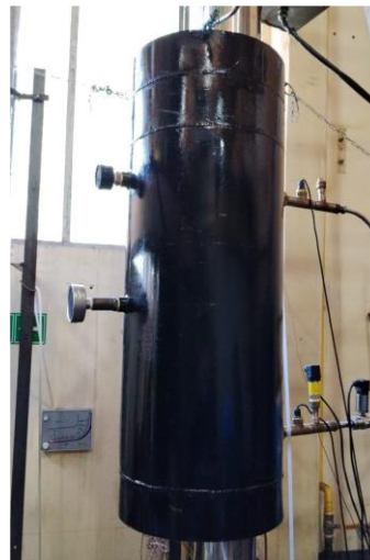
Figura 22: Recuperador de calor
