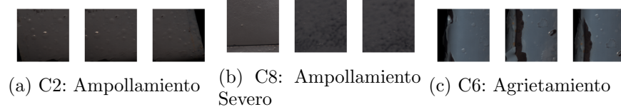
Figura 13: Defectos físicos. (a) y (b) Ampollamiento (Blistering). (c) Agrietamiento (Cracking) con exposición de sustrato. (Ver versiones ampliadas en Anexo 22)
