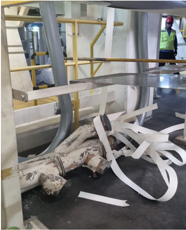
(b) Atasco en la PASABAN 4 debido a la falta de ducto extractor.
