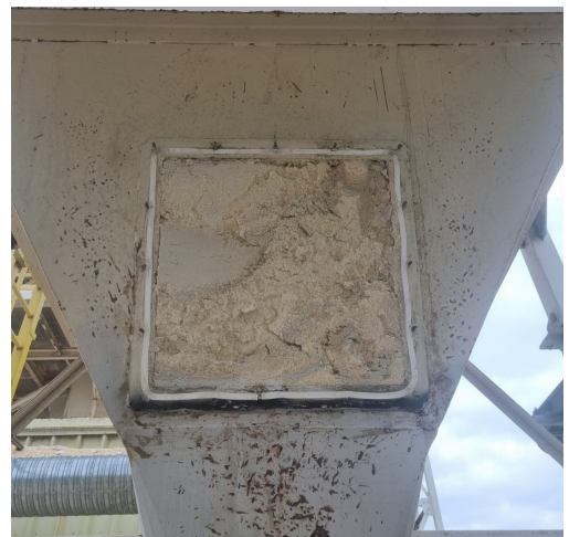
(b) Polvo retenido en la tolva de FM2 al retirar la compuerta de inspección.
