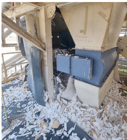
Figura 2.3.3 Separador 213C operando con la descarga de sólidos abierta.
