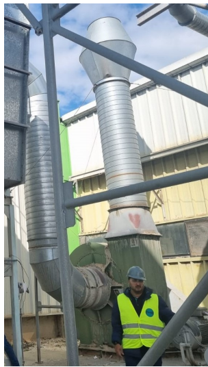
(a) Ventilador Centrífugo FM1
