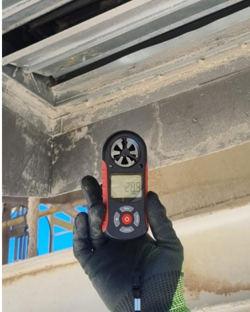
(a) Medición de humedad relativa (28,9 %) en ducto asociado al separador B [e.p.].
