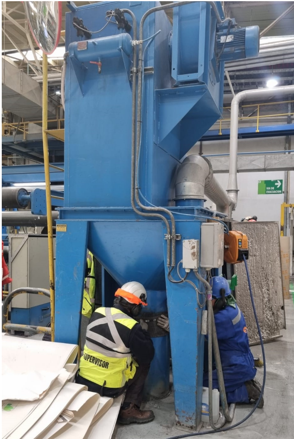
Figura A.1.32 Mantenimiento a filtro de mangas rebobinadora e.p.
