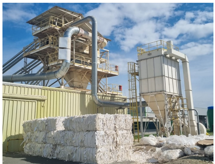
(b) Separadores y filtro de mangas 2
