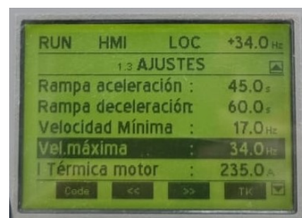
Figura 3.3.4 Pantalla VDF ventilador centrífugo 1 durante la inspección en terreno.
