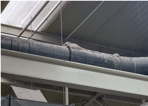
(b) Acumulación de polvo en ductos de extracción y sobre la máquina.
