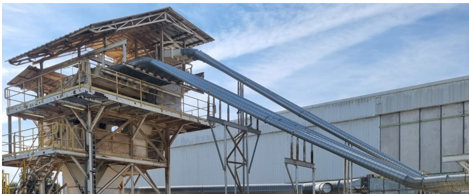
Figura 2.3.1 Ductos de entrada a separadores y descarga hacia enfardadora [e.p.].
