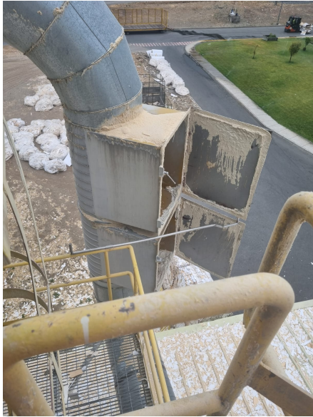
(a) Compuerta de mantenimiento abierta en el separador.
