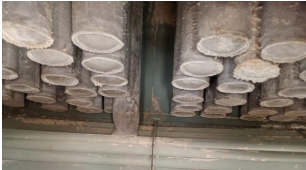
(a) Manga filtrante desprendida durante la inspección del filtro.
