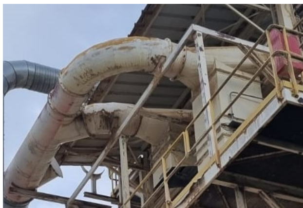
Figura 3.2.2 Descarga común de los separadores 213A y 213B en la Línea 1, con desbalance de tiraje entre ramas.
