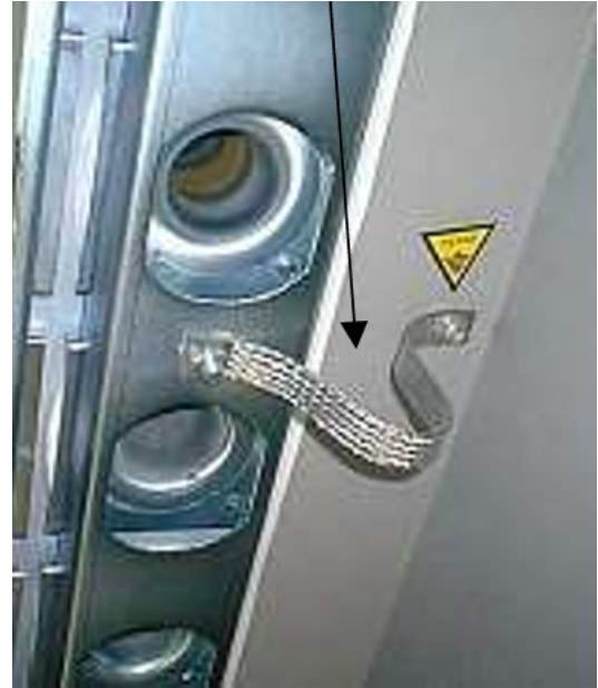
(b) Ejemplo de conexión a tierra en filtros de mangas industriales (NEU-JKF) para disipación de carga electrostática.
