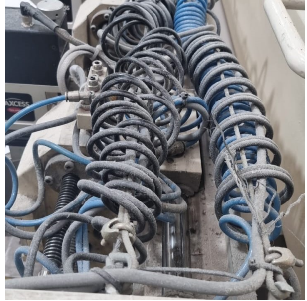
(b) Polvo visible acumulado sobre cables.
