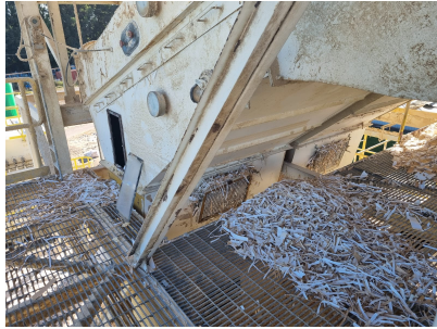
(a) Fugas en el separador 213A, registradas el 09/03/26.
