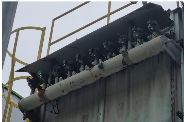
Figura 3.3.8 Válvulas Jetpulse no conectadas
