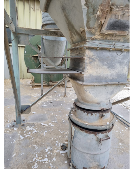
(b) Descarga inferior del filtro de mangas FM1 abierta al ambiente.
