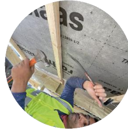
FALTA DE TOLERANCIA - RETIRO DE PIEZAS
