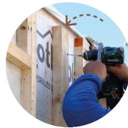
PIEZAS AUSENTES - INCORPORACIÓN EN OBRA
