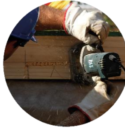
FALTA DE FRESADO - REALIZADO EN OBRA
