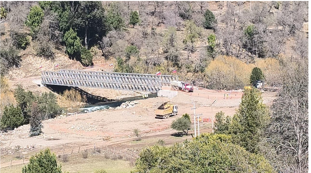
Fotografía N° 5. Vista panorámica de la construcción del nuevo puente Chichintawe. Fuente: Elaboración propia. Fecha: 12 de septiembre de 2024.
