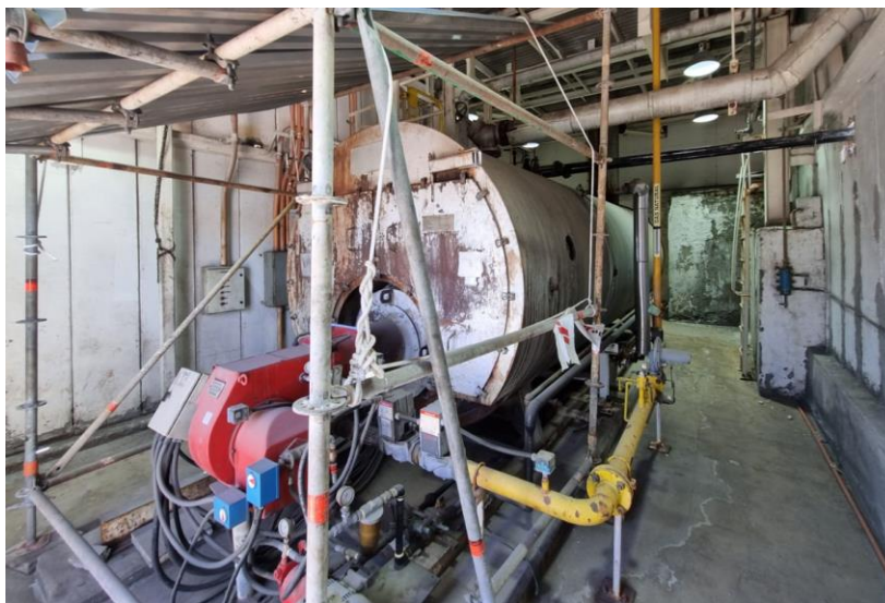
Figura 8.4: Imagen de la caldera 730-B1, obtenida de la localidad Talcahuano (confección propia)
