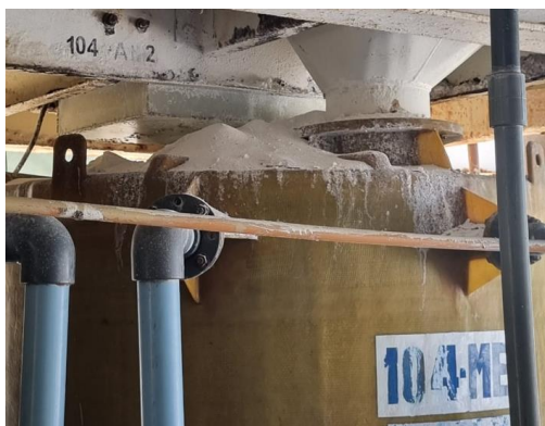
Figura 1.5: Acercamiento a sección superior de estanque de preparación de solución de carbonato de sodio (confección propia)
