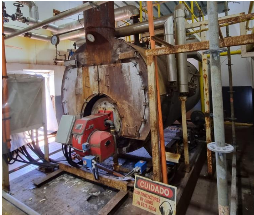
Figura 2.3: Imagen de la caldera 720-B1, obtenida de la localidad Talcahuano (confección propia)
