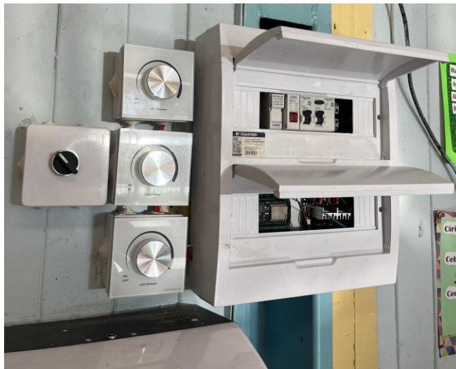
Fig. 26: Tablero de Alumbrado y control con selector y dimmer manuales. Elaboración propia.
